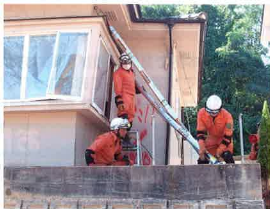
倒壊防止補強作業(ショアリング)を実施 三重県大隊(上)と京都府大隊(下)
